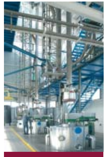
Autoclave Procédé Diamant® Chargement et vidange du granulé par voie pneumatique (aspiration et soufflage) en ambiance étanche
